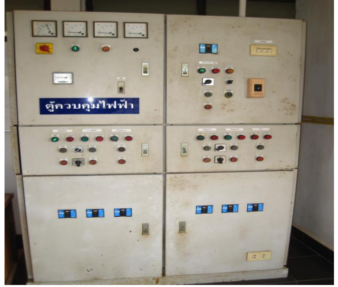
ตู้ควบคุมไฟฟ้า
