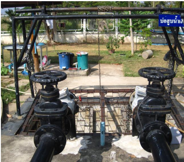
บ่อสูบน้ำเสีย
