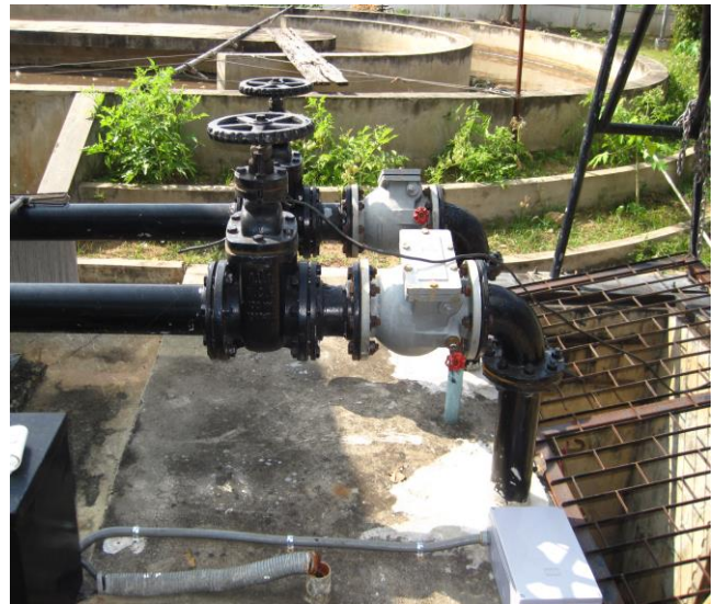
เครื่องสูบน้ำเสีย 2 เครื่อง
